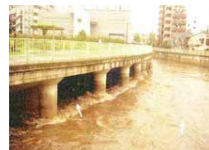
神田川取水施設取水状況
